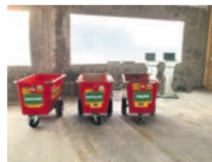
SORTERING: På det meste var det femten containere for ulike avfallsfraksjoner pluss egne traller som de ansatte kunne bruke inne i bygget.
